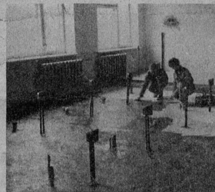
НА СНИМКАХ: М. Антонова из бригады Н. Пархоменко (участок № 3 УОР) накладывает последние «штрихи» на столарку; сварка арматуры для крепления облицовки на фасаде школы; подго-
