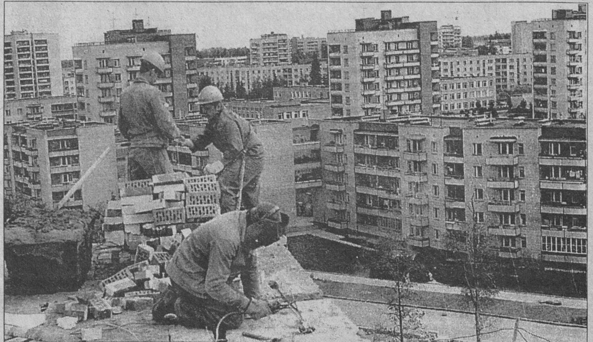
1984 год, апрель. Ленинский коммунистический субботник. Бригада каменщиков заслуженного бригадира, кавалера ордена Ленина И.Баранова завершает строительство секции дома №5 по проспекту Героев. Фото Г.Сафонова (из архива редакции)
