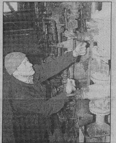
На снимках: так выглядит рабочий зал бойлерной; за дистанционным щитом управления бойлерной - начальник смены Александр Малых; участок оборудования котельной под контролем старшего оператора Василия Воронина. Фото Г. Сафонова
