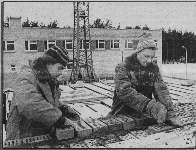
На снимках: штукатурные работы ведут Н. Богатова и Л. Вебер; продолжается строительство школы №9; каменщики (слева направо) Д. Корнилов и М. Перепелкин Фото Ю. Шестернина
