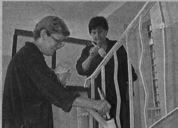
Лестничную клетку школы № 1 обновляют заместитель директора по АХЧ Г. Шишибарова и воспитатель группы продленного дня Н. Биличенко.
